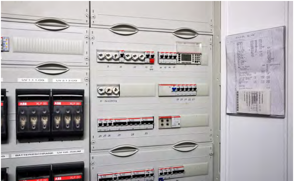
Abb. 4 Stromkreiskennzeichnung und zugehörige Dokumentationen einer elektrischen Unterverteilung
