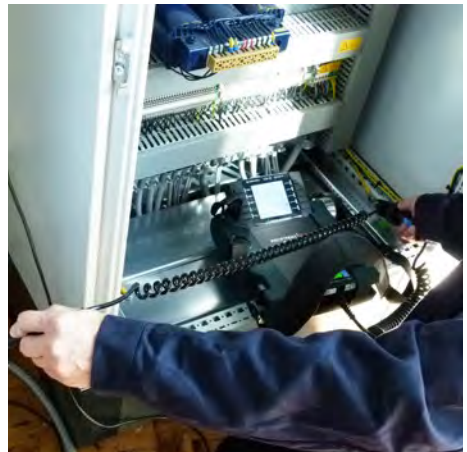
Abb. 11 Schutzleiterwiderstandsmessung; Messung der niederohmigen Schutzleiterverbindung; Schaltschrank
