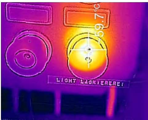
Abb. 24.2 Verteilung mit Diazed-Sicherungen; Thermographiebild
