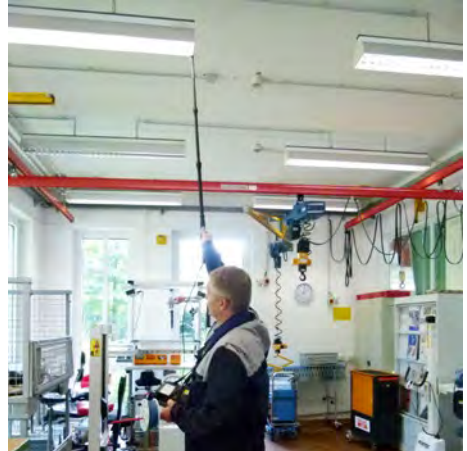
Abb. 9 Messung der niederohmigen Schutzleiterverbindung; Leuchte
