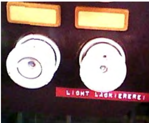
Abb. 24.1 Verteilung mit Diazed-Sicherungen
