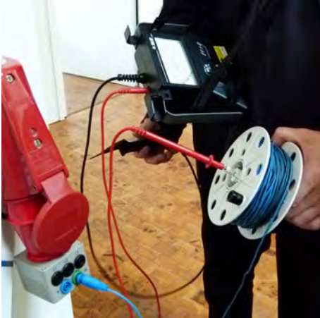
Abb. 8 Messung der niederohmigen Schutzleiterverbindung
